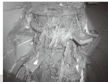
漁網が絡まって停止し、ごみ処理に支障をきたしている破砕機
