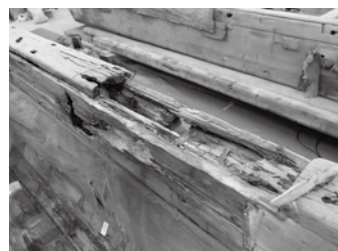
修繕が必要な箇所
