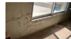
窓周辺が劣化している状況（白丸公民館）
