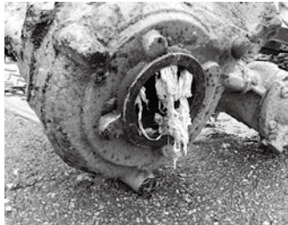
ポンプに異物が詰まった状態
