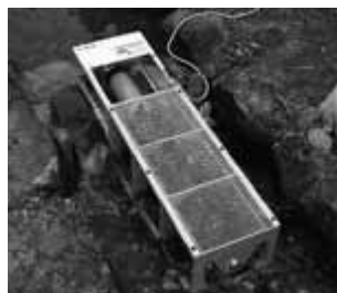
▲近くの用水路に設置された小水力発電。案内板のLED照明に電気を送る。
