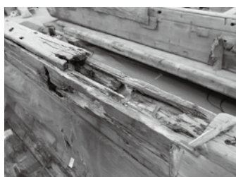
修繕が必要な箇所
