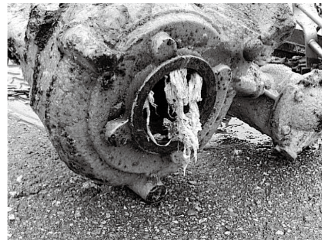
ポンプに異物が詰まった状態
