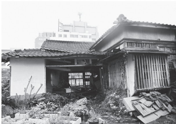
※危険な空き家（インターネットより）
