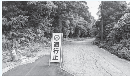
通行止めとなっている農免道路
