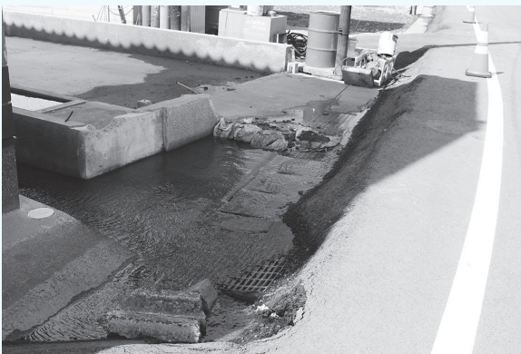
排水溝から逆流する海水
