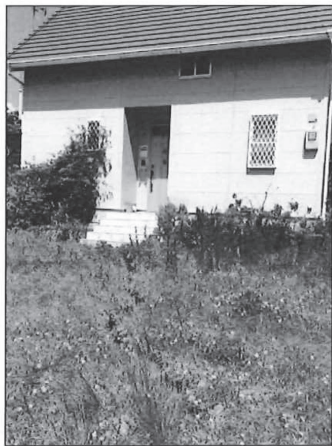
【外観による判定のみで「全壊」と判定】
