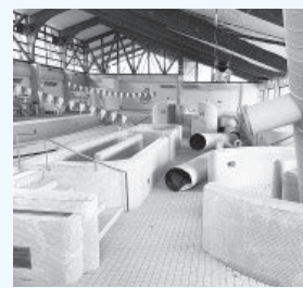
被害の大きかった「なごみ」プール棟
