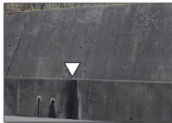
地下水の流出
