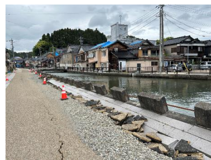
公共土木施設の被害の様子
