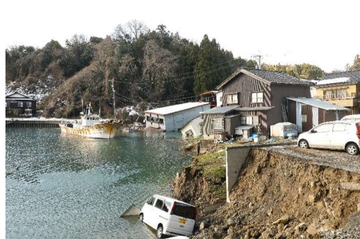
⑫ 護岸崩落
