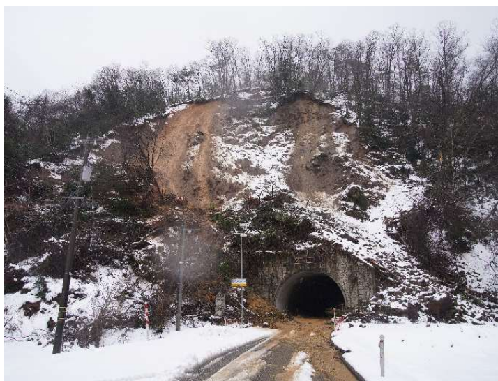
② トンネル上の法面崩落
