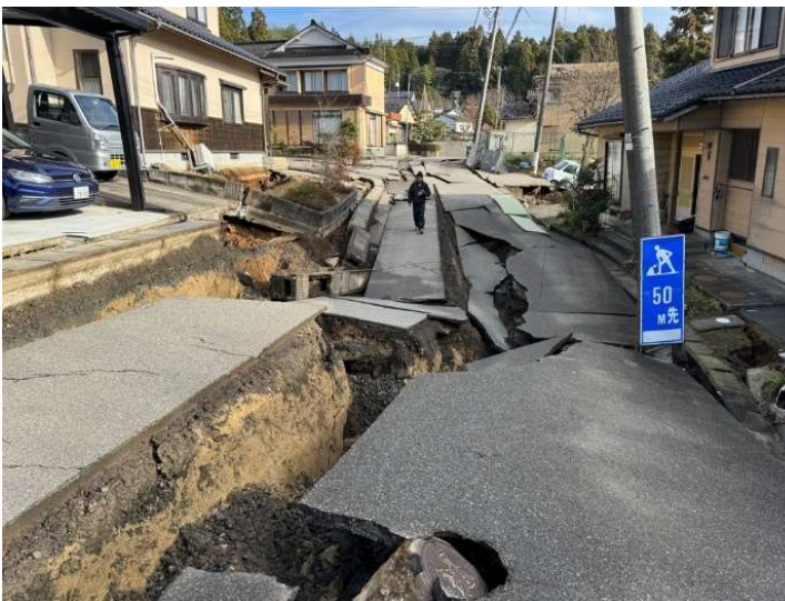
⑧ 道路陥没
