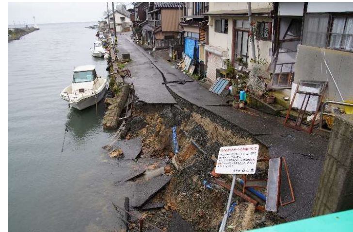
⑥ 護岸崩落
