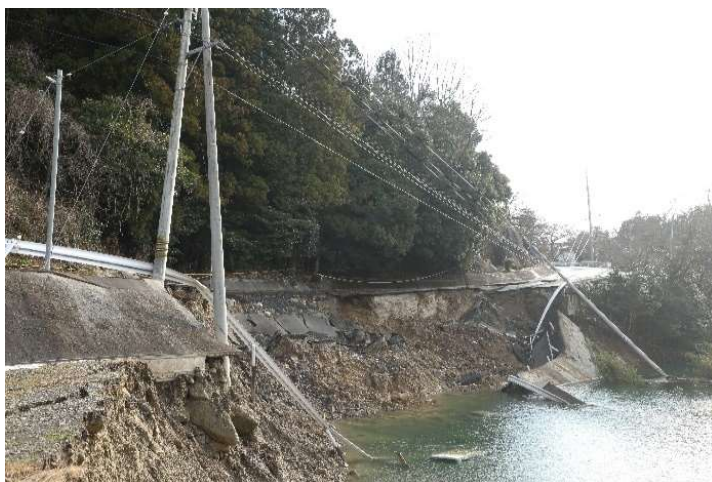
⑪ 護岸崩落による道路寸断
