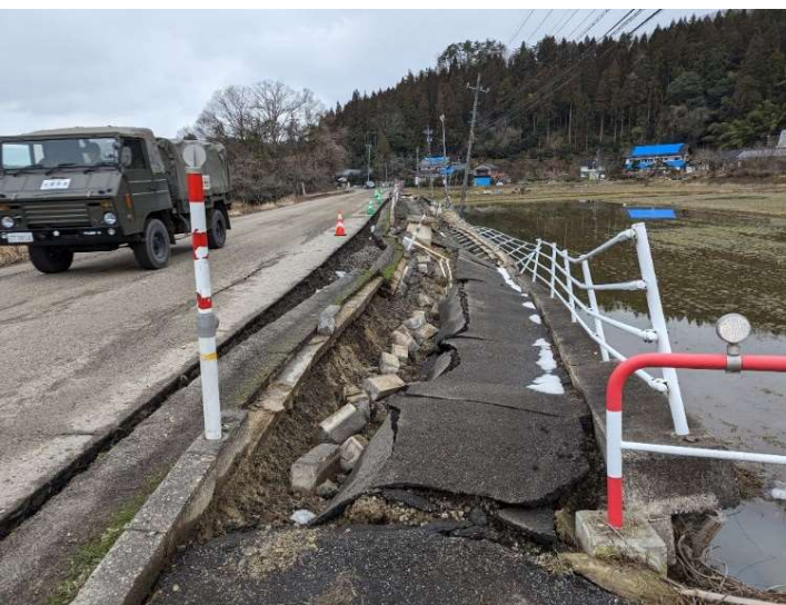
⑲ 歩道崩落
