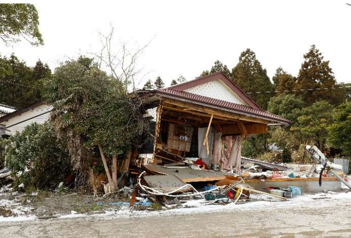
⑬ 津波による家屋損壊
