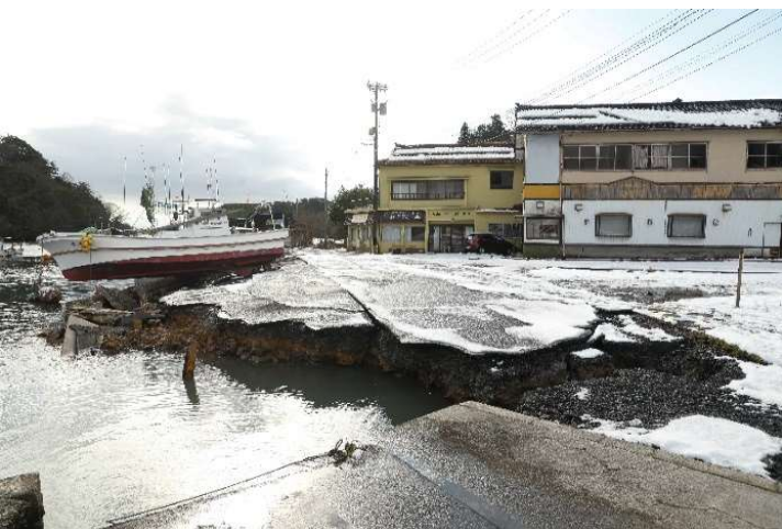
⑩ 護岸崩落
