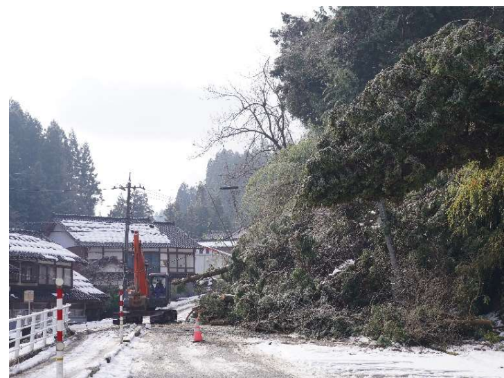
③ 法面崩落による道路寸断
