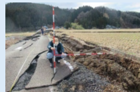
被災箇所測量
