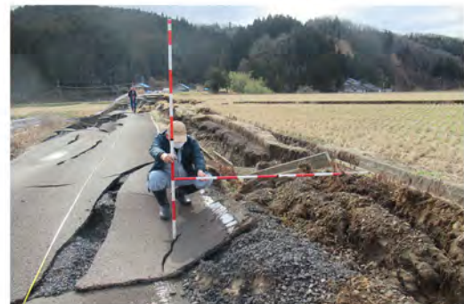
被災箇所測量
