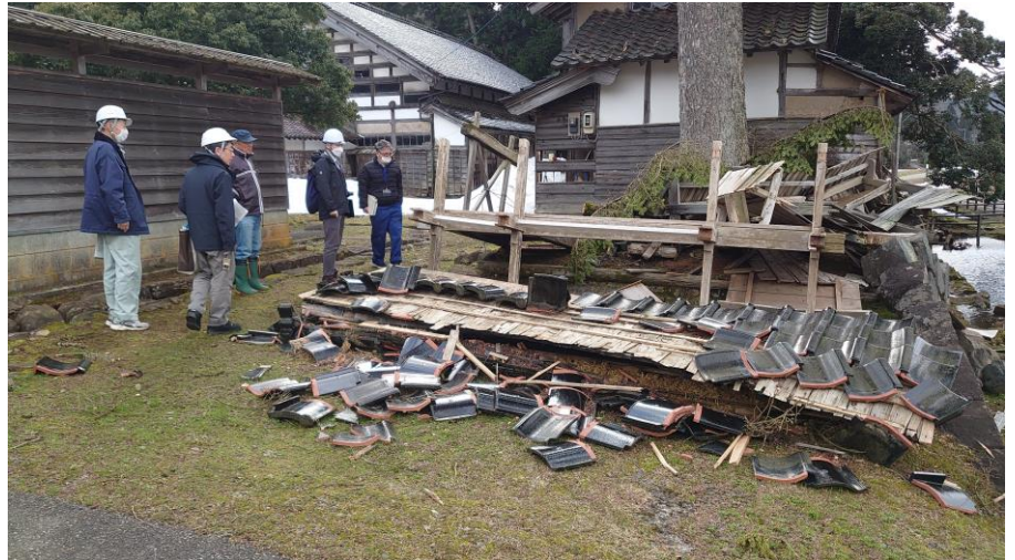
被害を受けた国重要文化財（建築物）中谷家住宅
